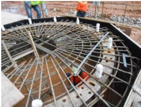
Figura 21 : Detalhe das Bases antes da concretagem e após a concretagem – observem os chumbadores e template
